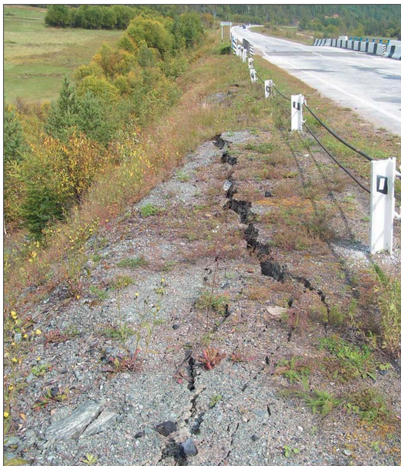
Рис.8. Сейсмогравитационная трещина в насыпи автодороги Култук—Монды.
