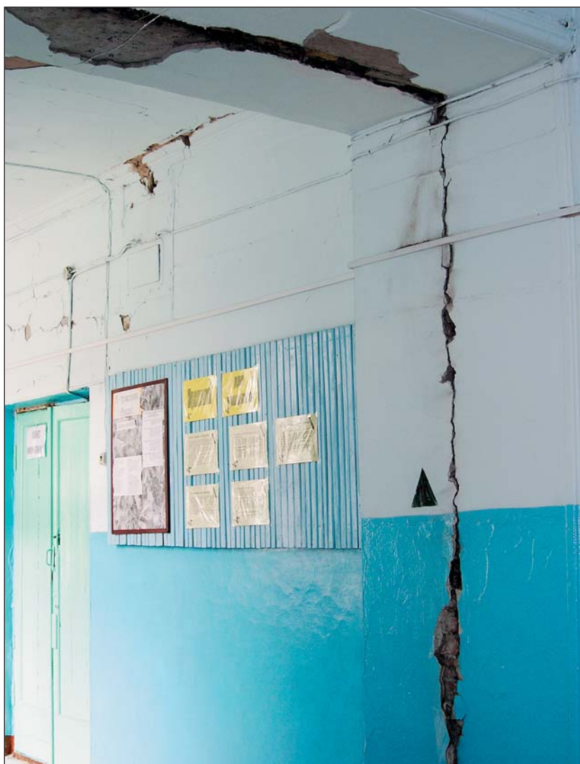
Рис.6. Трещины в стенах здания школы в пос.Култук.
