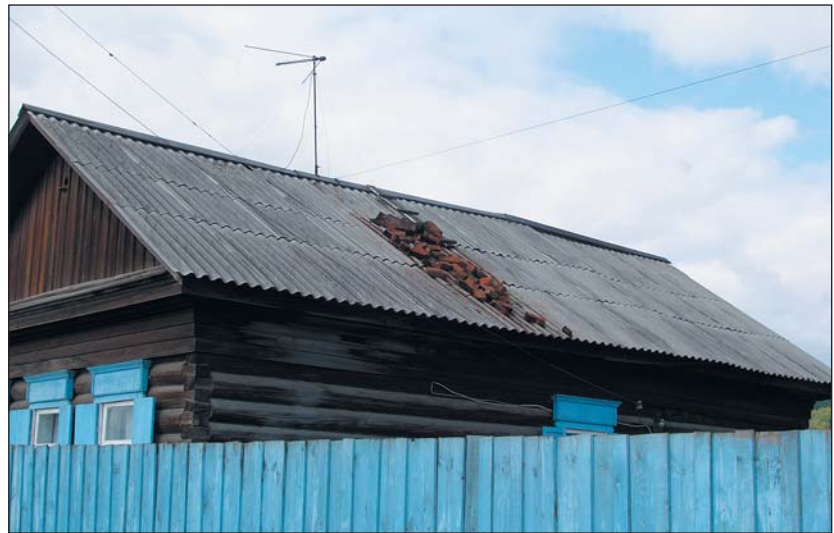
Рис.4. Разрушение печных труб в Култуке. Подобные эффекты носили массовый характер.
